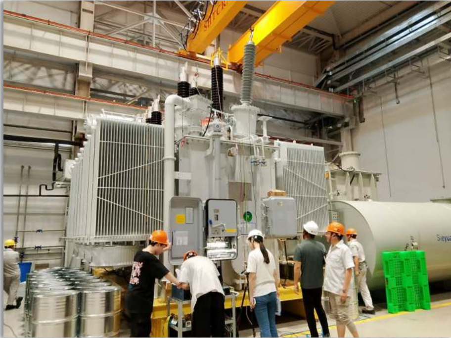
Pruebas transformador 115KV
