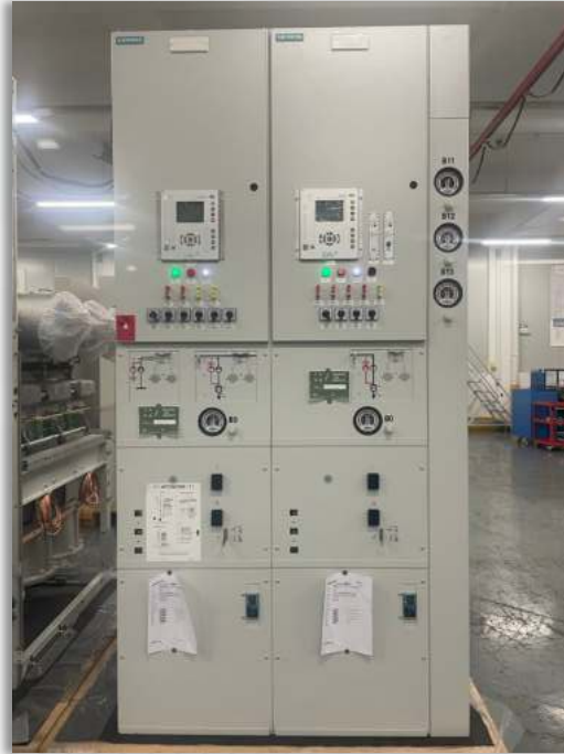
Pruebas Tableros de Control
