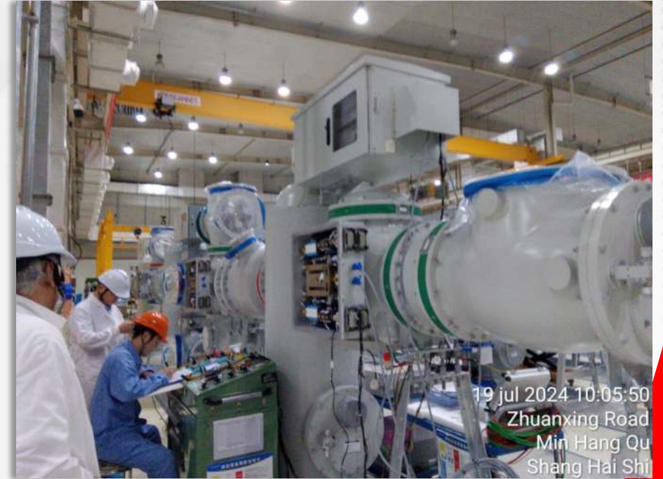
Pruebas módulo GIS (Subestación Aislada por Gas - Gas Insulated Substation).
