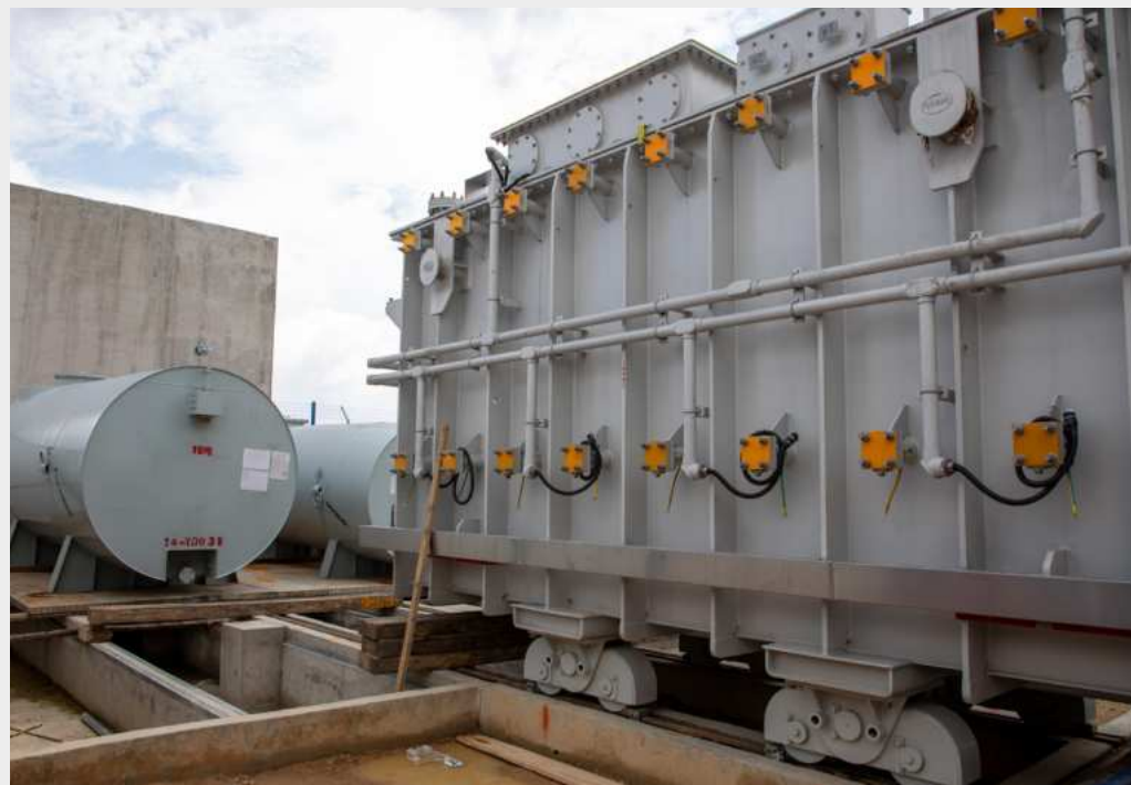
Subestación Receptora 1 Patio Taller
