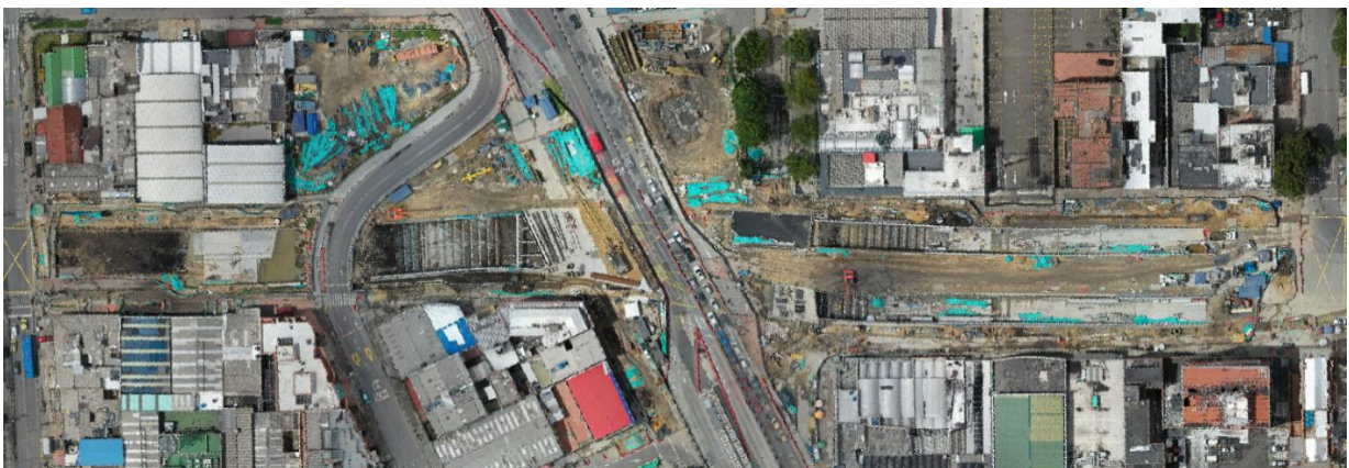
Figura 3.2.1.3-3. Avance físico de obra en Calle 72 con Av. Caracas durante el mes de abril de 2024 planta general
