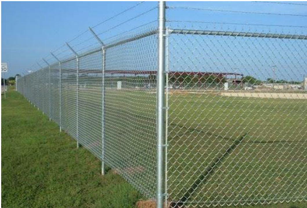
Figura 1 Ejemplo Cerramiento en malla eslabonada
