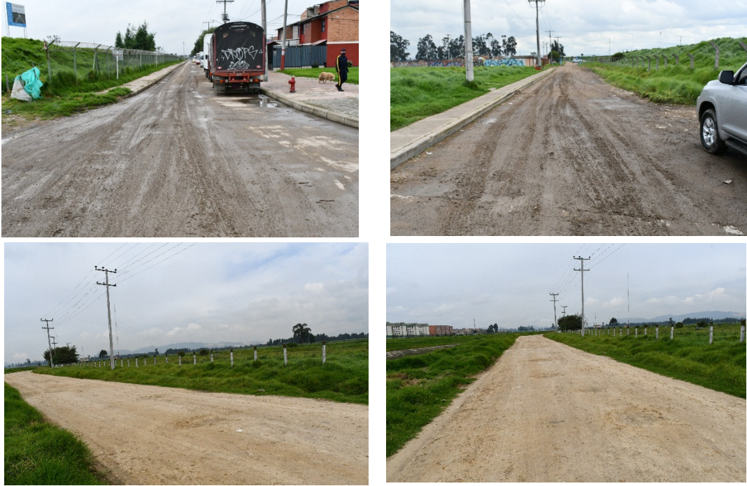
Figura 1. Estado de la vía de acceso - Patio Taller
