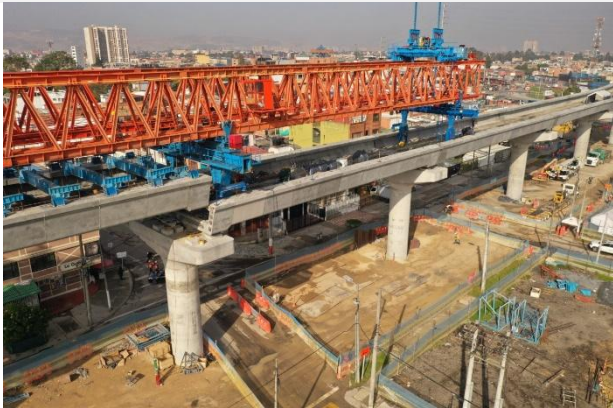
Viga Lanzadora 8 (S10-15)
