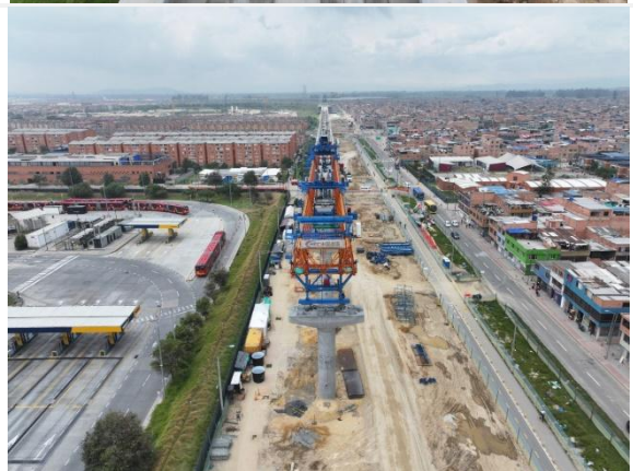
Viga Lanzadora 3 (S2-24)
