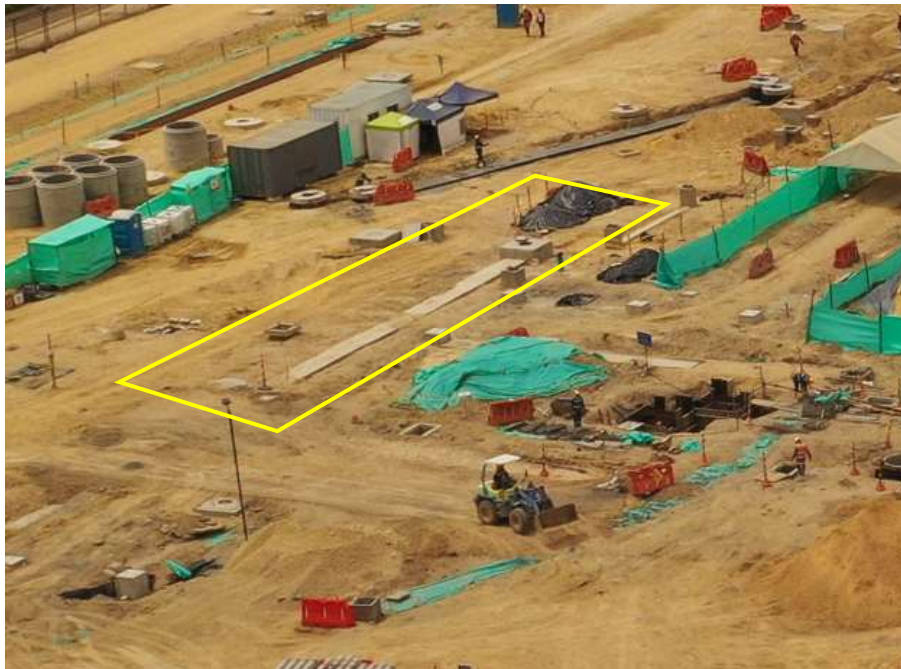
Ilustración a.2.1-13. UE 37 Edificio 113, Estación de servicio avance de obra al 28 de febrero de 2025, vaciado de concretos pedestales.
