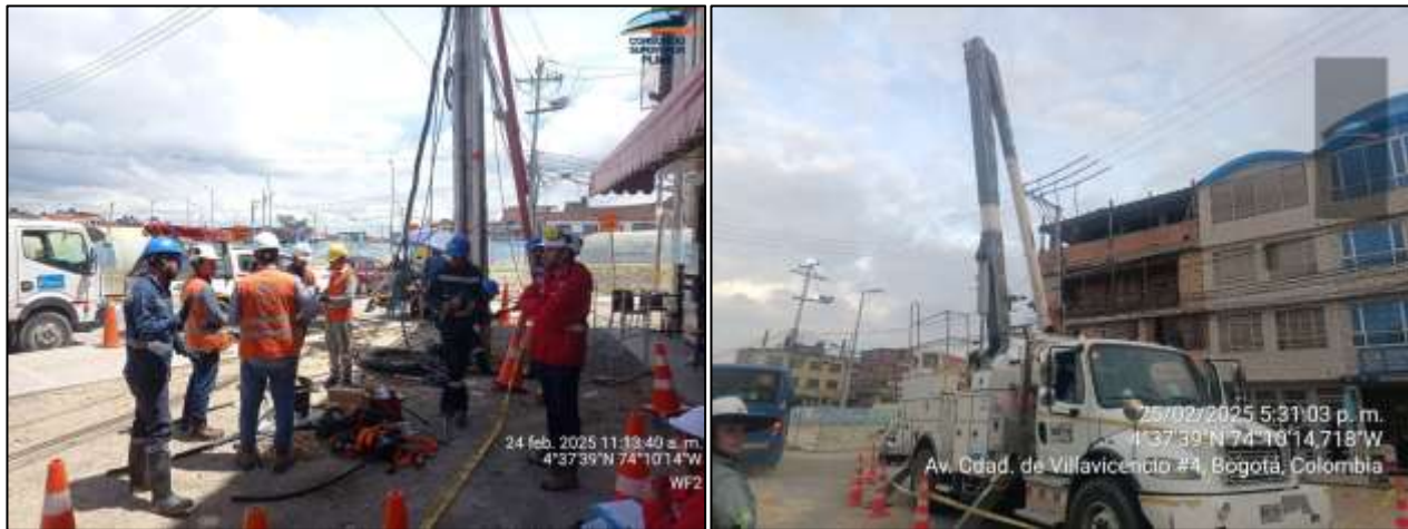
Ilustración a.2.5-2. Registro fotográfico de las actividades adelantadas de la red ENE2-18 – Interferencia aérea. Fuente: Recorrido de interventoría – elaboración propia, registro fotográfico incluido en anexo a.2.5, numeral a.2.5-4 Registro fotográfico actividades realizadas para el traslado de redes.
