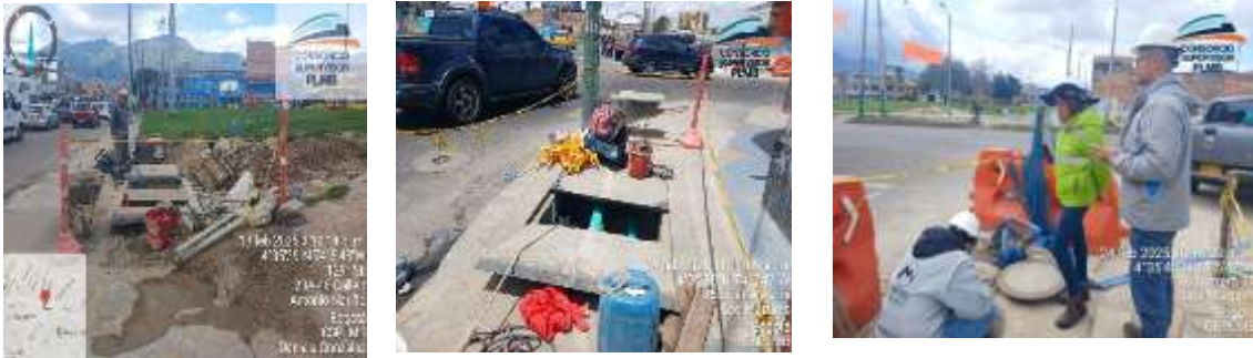
Ilustración a.2.7-2. Registro fotográfico de la red ENE 4-05
