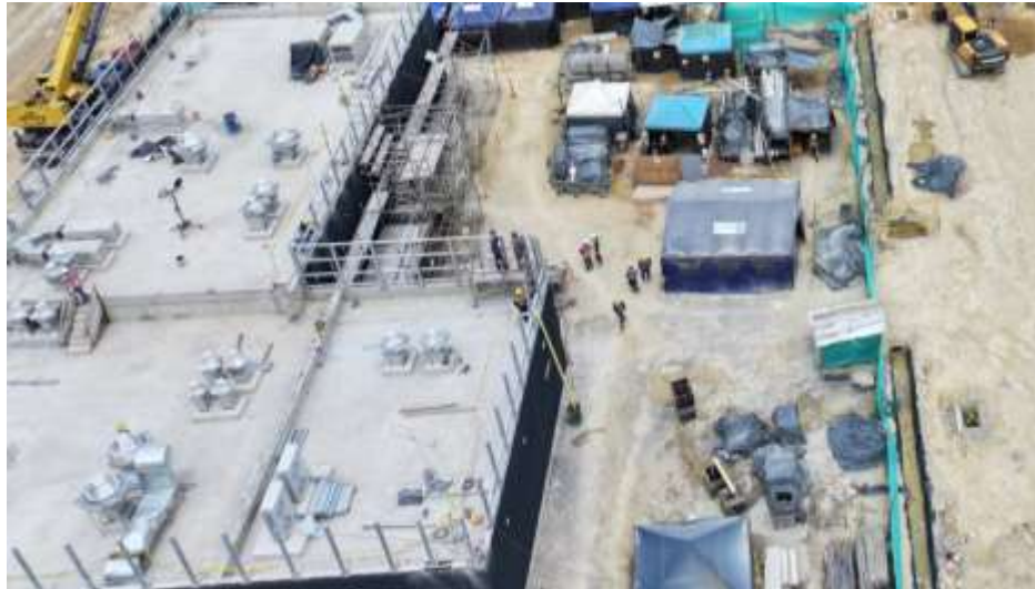
Ilustración a.2.1-17. UE 408 SET. Avance general vista costado norte, montaje de fachada metálica.
