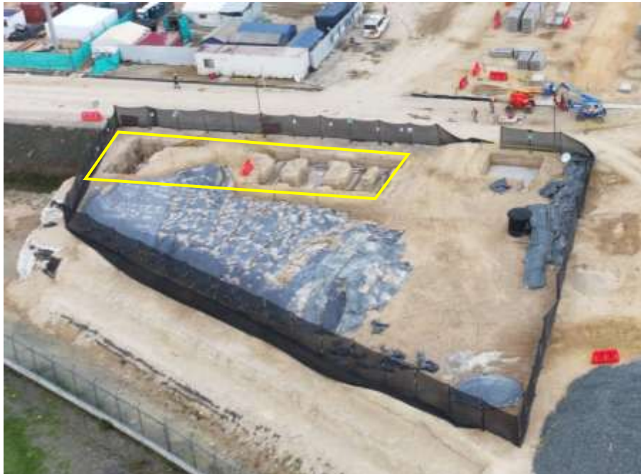
Ilustración a.2.1-3. UE 31 Edificio 103, Caseta Control de Acceso avance de obra al 28 de febrero de 2025, se aprecia el armado de acero para la cimentación.
