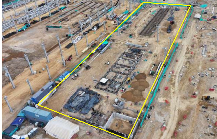
Ilustración a.2.1-7. Avance general de actividades UE 35 Edificio 107, Mantenimiento de infraestructura, construcción de cimentación principal, rellenos en material granular y montaje de columnas metálicas.
