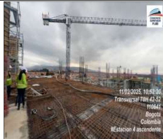
Se realiza Armado de acero placa de nivel de plataforma, Edificio 2. Eje F-G 1-3
