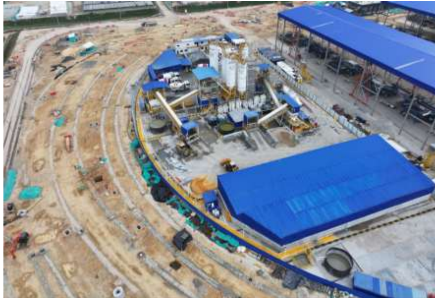
Ilustración a.2.1-20. UE 38 Redes externas patio taller. Construcción de filtros en haz de vías y de cajas de inspección para red pluvial.
