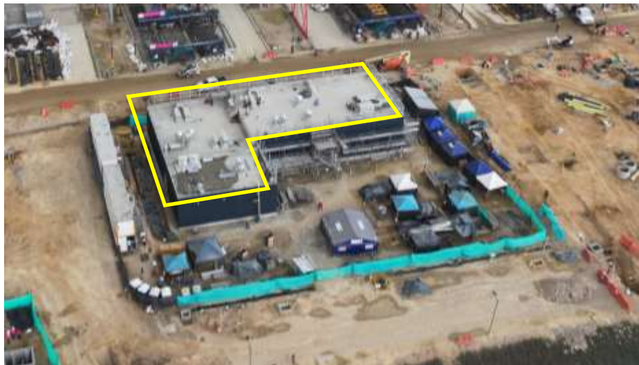
Ilustración a.2.1-16. UE 408 SET. Avance general vista costado nororiental, montaje de equipos de HVAC y recubrimiento de fachadas.
