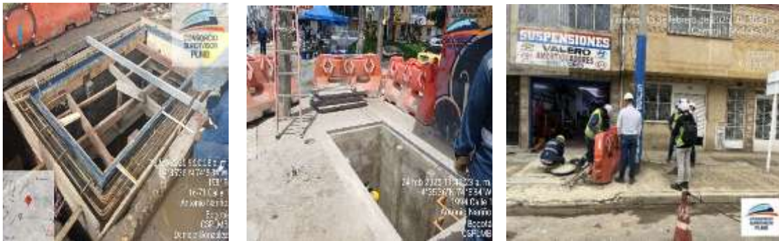
Ilustración a.2.7-5. Registro fotográfico de la red ENE 4-06
