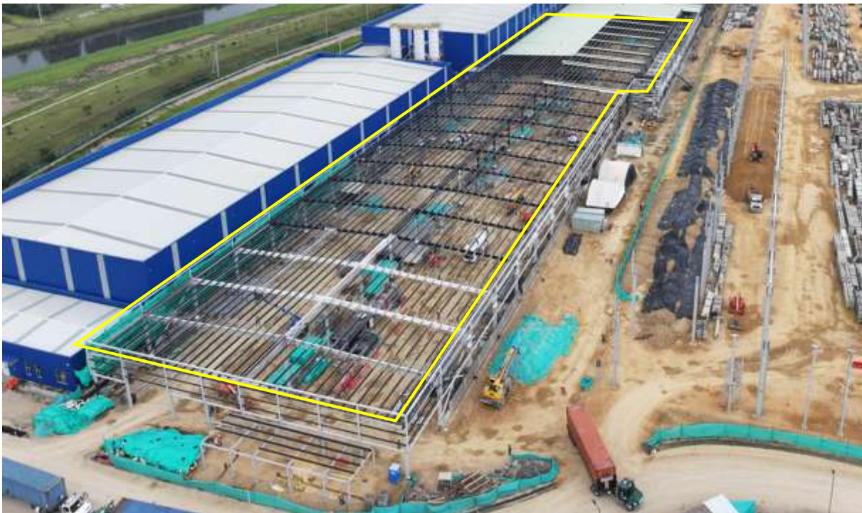
Ilustración a.2.1-5. Actividades UE 32 Hall de cocheras Edificio 104, montaje de correas de cubierta.
