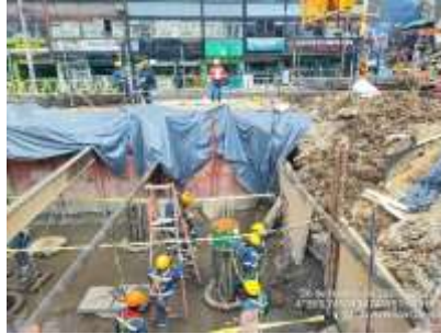
Ilustración a.2.9-16. Inicio de construcción para dado en el apoyo S16-07 UE203
