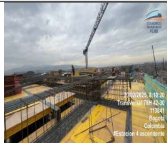
Se realiza armado de aceros C9 ejes I-J 2-3 en nivel de cubierta
