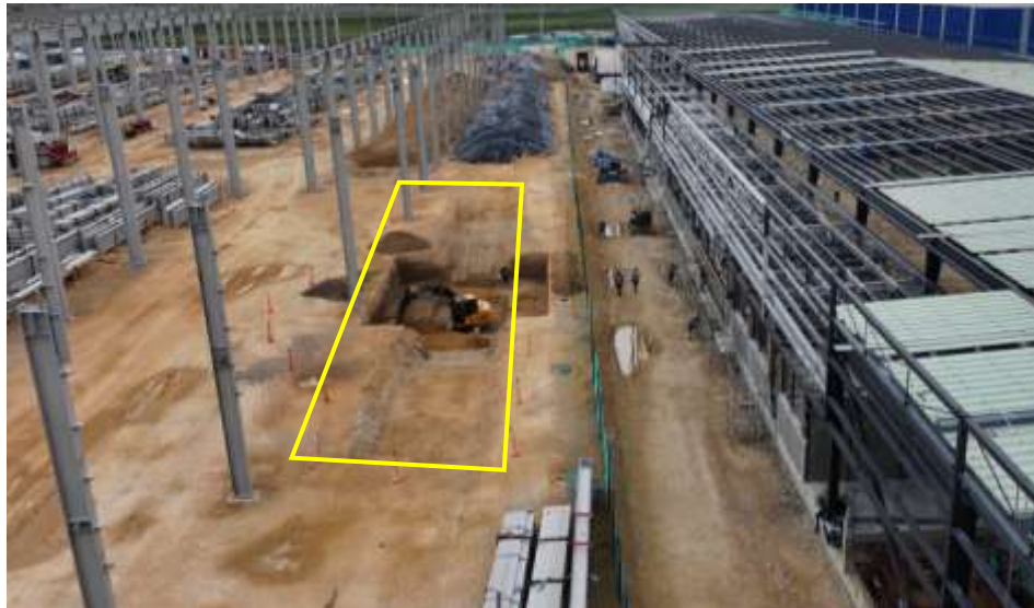
Ilustración a.2.1-12. Avance general de actividades UE 36 Edificio 112, torno en foso, inicia excavaciones.
