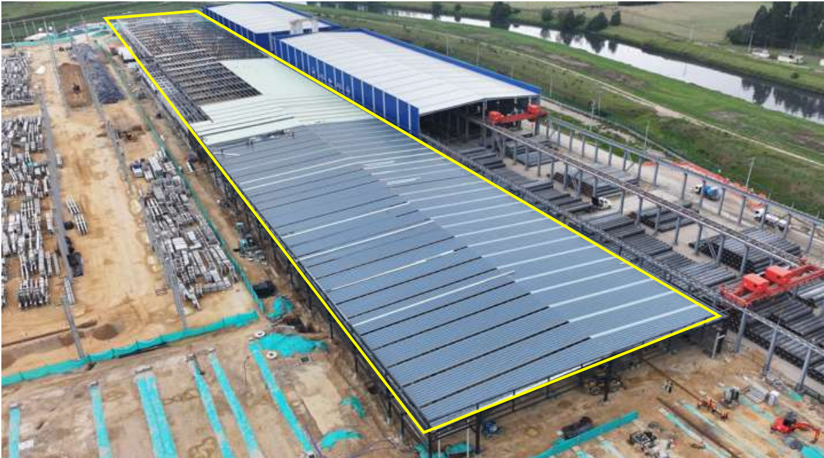
Ilustración a.2.1-4. Actividades UE 32 Hall de cocheras Edificio 104, montaje de cubierta metálica.
