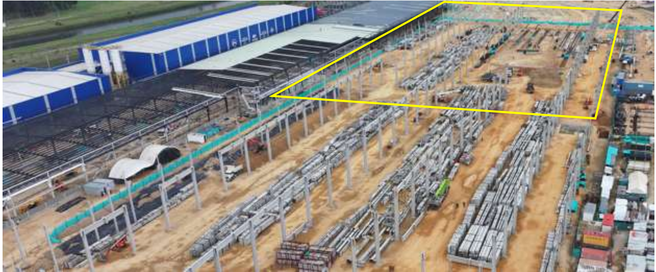
Ilustración a.2.1-9. Actividades UE 36 Edificio 108, Mantenimiento mayor y menor, montaje de columnas y vigas aéreas estructura metálica.
