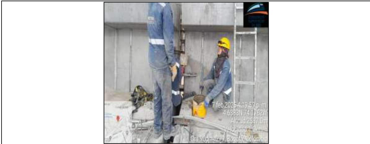
Se realiza sello de cajetines en cara de dovela S02-05-13 de los vanos S02-02 al S02-05
