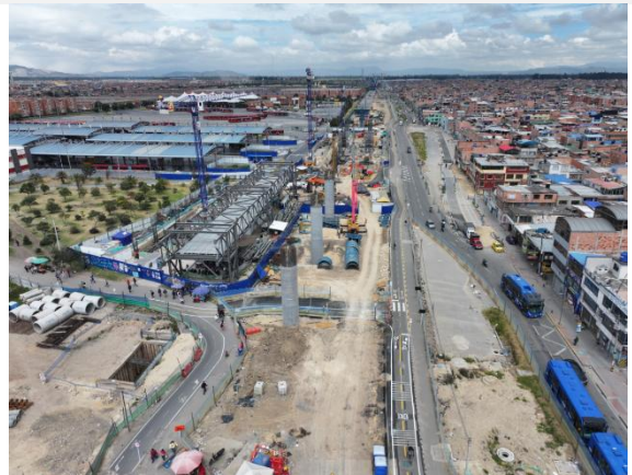
Figura 3.3-20 Avance físico de obra en Frente de Trabajo 1 (WF1) – zona de Ramal técnico, durante el mes de enero 2025
