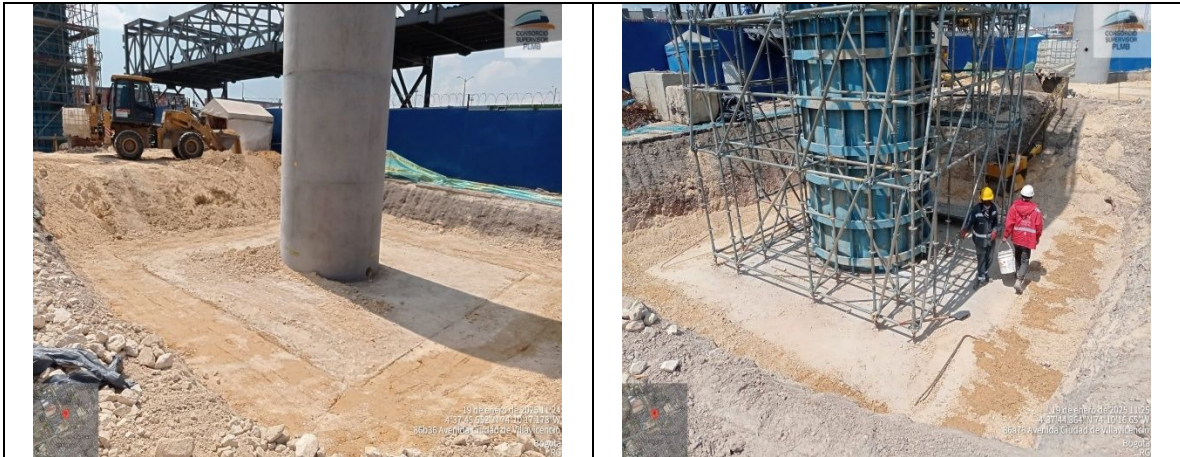
Se realiza relleno perimetral y compactación de material en excavación de dado S3-1 al S3-3
