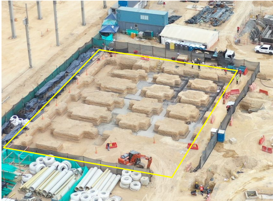
Ilustración a.2.1-2. UE 31 Edificio 102, Administrativo avance de obra al 31 de enero de 2025.
