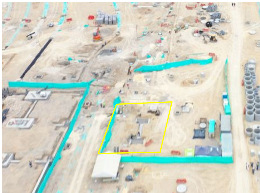
Ilustración a.2.1-12. UE 37 Edificio 113, Estación de servicio avance de obra al 31 de enero de 2025.
