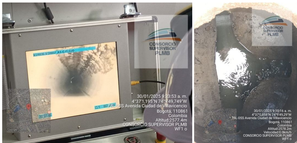
Ilustración a.2.5-16. Registro fotográfico de las actividades adelantadas de la red de alcantarillado sanitario SAN2-10. Fuente: Recorrido de interventoría – elaboración propia, incluido en anexo a.2.5, numeral a.2.5-6 Registro fotográfico actividades realizadas para el traslado de redes
