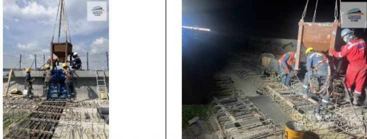
Instalación de concreto en dovela S01-06-16 (tipo W2- G). Vano S1-06, UE156
