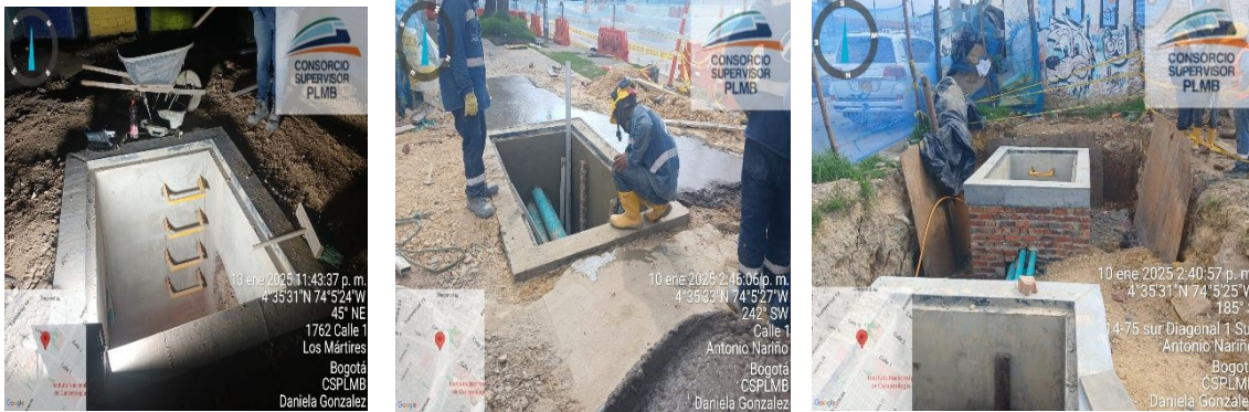
Ilustración a.2.7-9. Registro fotográfico de la red ENE 4-07
