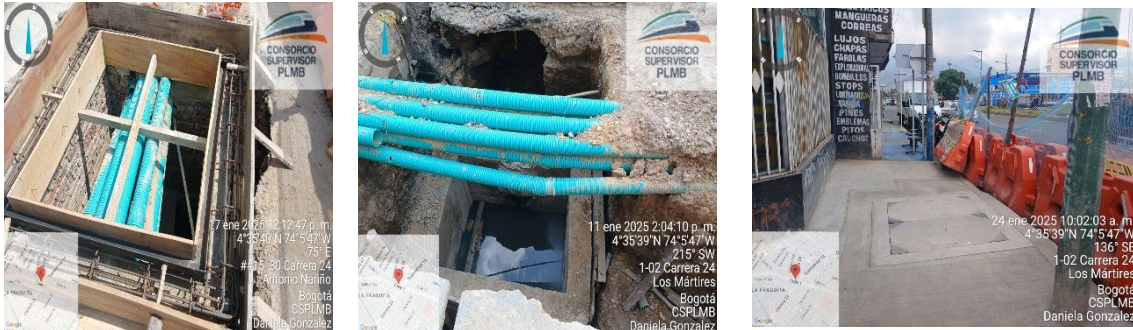
Ilustración a.2.7-3. Registro fotográfico de la red ENE 4-05
