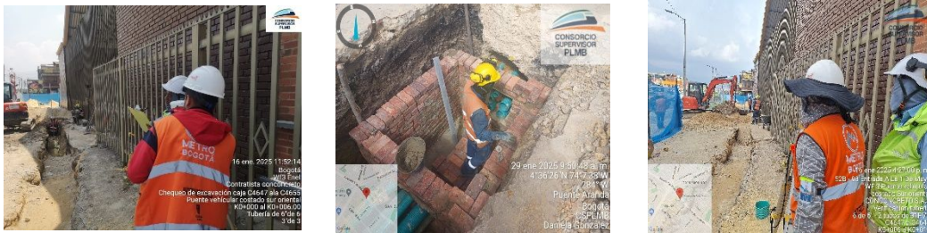
Ilustración a.2.6-8. Registro fotográfico de las actividades adelantadas de la red red ENEL puente sur costado suroriental
