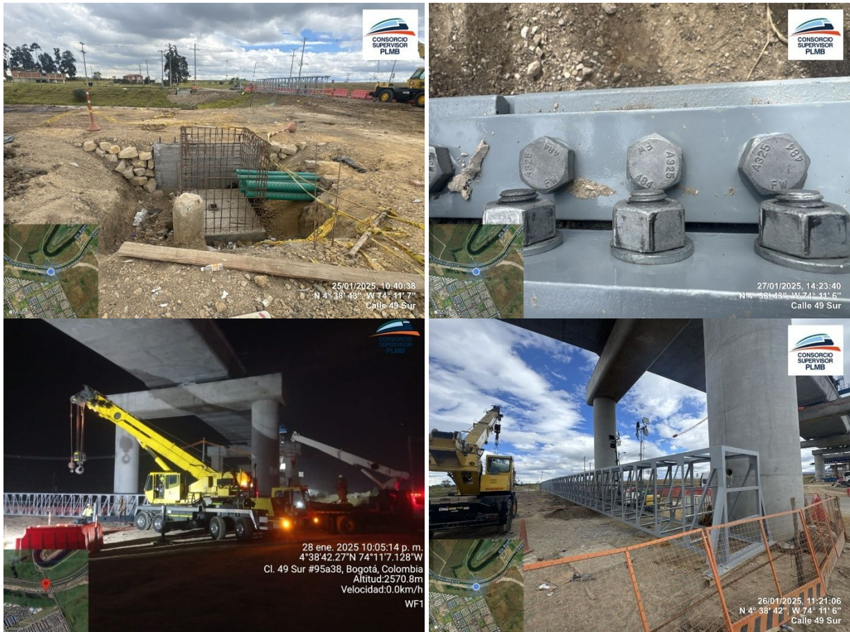
Ilustración a.2.4-2. Registro fotográfico de las actividades adelantadas de la red eléctrica ENE1-01
