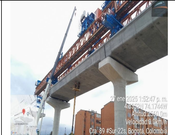
Se realiza la nivelación y posicionamiento de los vanos desde el S02-15 al S02-18
