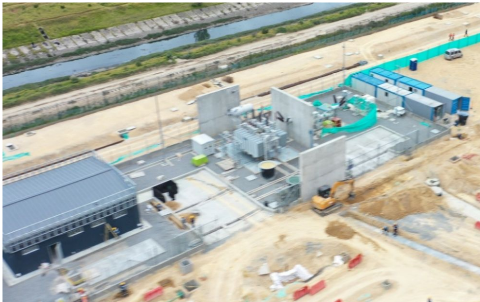
Ilustración a.2.1-16. Condiciones actuales del armado del transformador principal.
