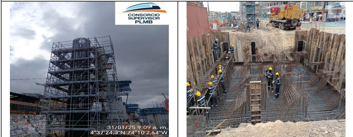
Armado de acero de refuerzo de la pila de los apoyos S3-26 y S3-27
