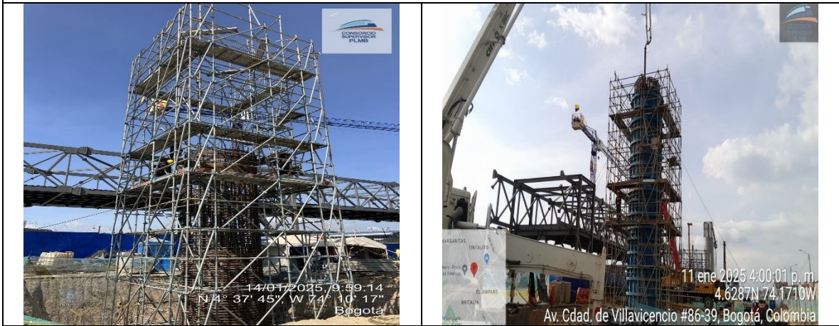
Apoyo S3-2 y S3-3 se realiza el armado de acero de refuerzo e instalación de concreto en pilas
