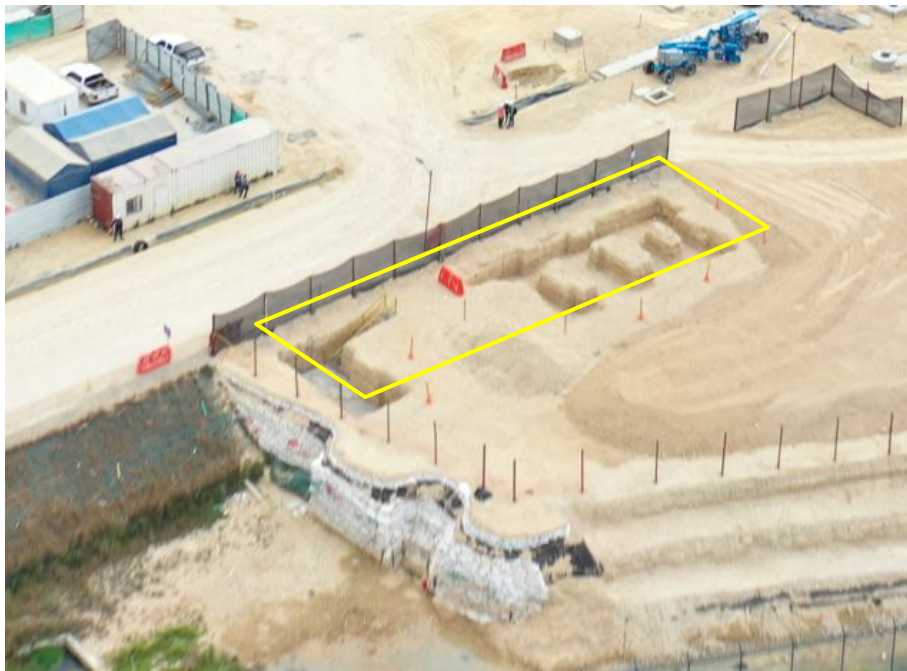
Ilustración a.2.1-3. UE 31 Edificio 103, Caseta Control de Acceso avance de obra al 31 de enero de 2025.
