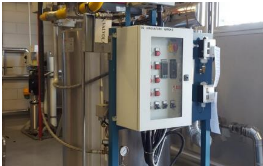
Fotografía 36 Sistema de control de temperatura
