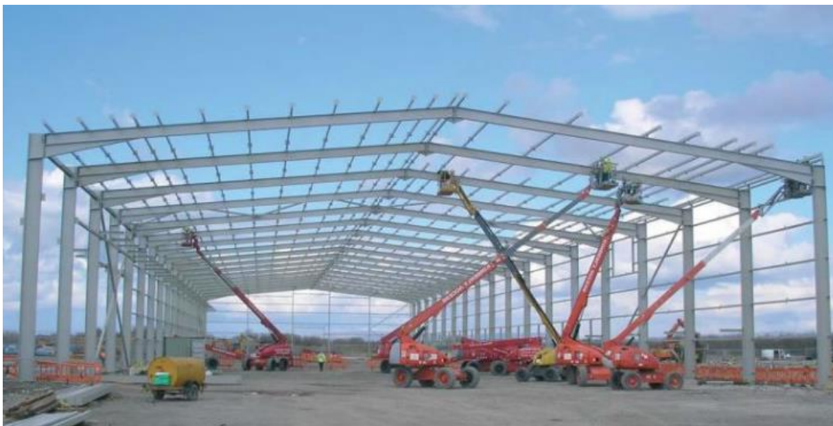
Figura 333 Imagen de referencia de estructura metálica principal y correas de cubierta terminadas
