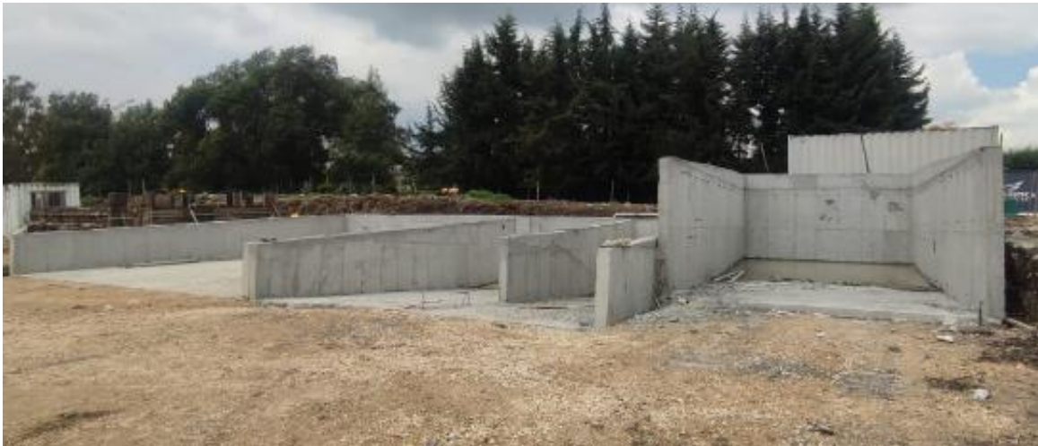
Fotografía 58 Zona de lavado y sedimentadores de planta de concreto
