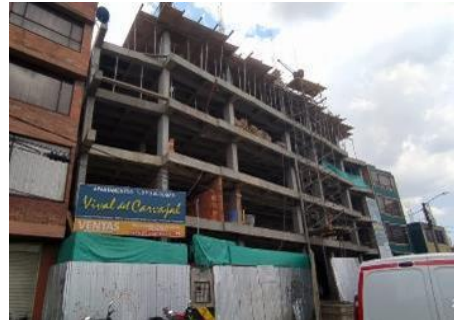
Fotografía 37 Construcción de viviendas– Tramo 1 Coordenadas Magna Sirgas Ciudad Bogotá: 89715,53 E, 104311,50 N. Localidad: Bosa Fuente: Metro Línea 1, 2023
