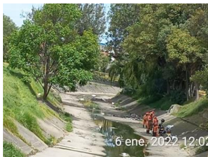
Fotografía 42 Limpieza del canal Río Seco- Tramo 3 Coordenadas Magna Sirgas Ciudad Bogotá: 95005,83 E, 100820,34 N. Localidad: Puente Aranda Fuente: Metro Línea 1, 2023
