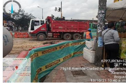
Fotografía 41 Mantenimiento de vía – Tramo 2 Coordenadas Magna Sirgas Ciudad Bogotá: 90236,58 E, 102693,89 N. Localidad: Kennedy Fuente: Metro Línea 1, 2023
