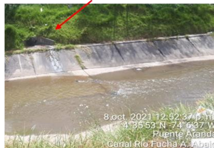
Fotografía 51 Conexiones erradas sobre Canal Rio Fucha
