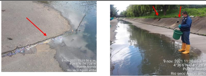
Fotografía 52 Vertimiento con trazas de hidrocarburos y conexiones erradas en Canal Río Seco
