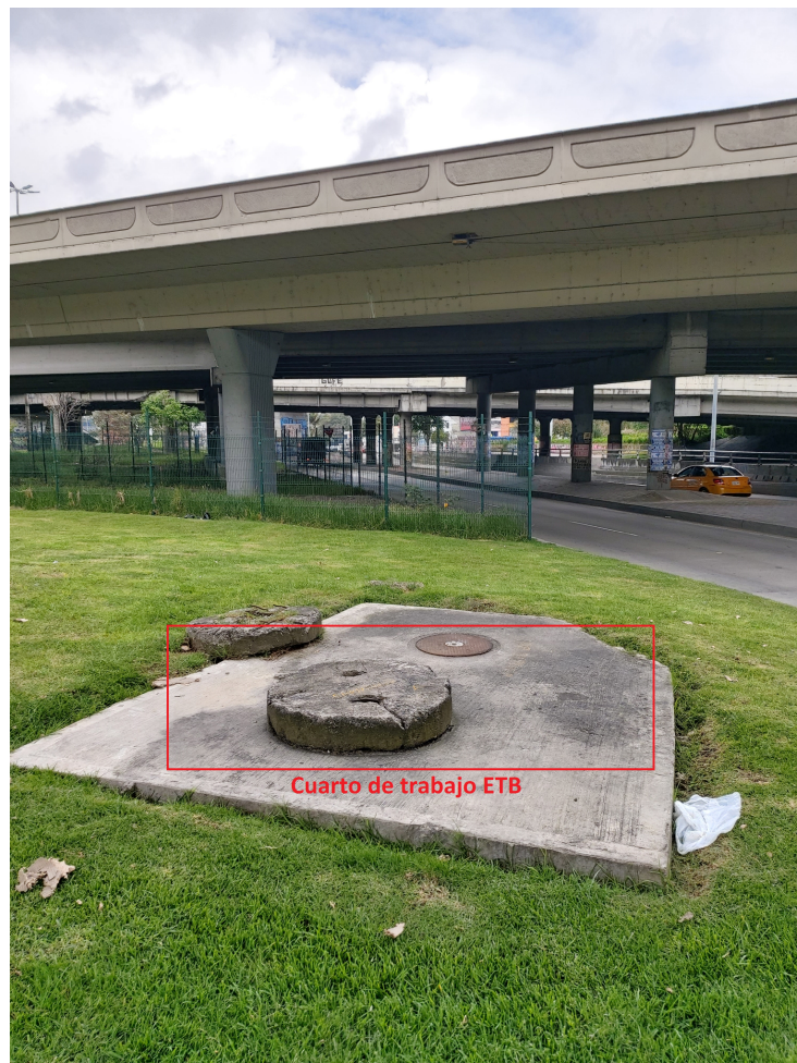
Fotografía 9. Redes de ETB sobre la diagonal 92 debajo del puente de la carrera 45 Fuente: Imagen de campo
