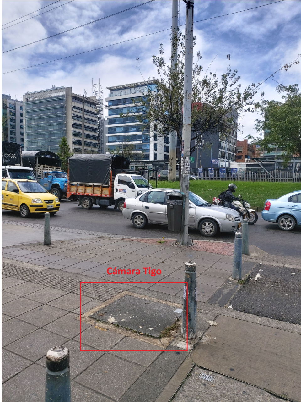
Fotografía 15. Redes de Tigo sobre la Av. carrera 45 # 95-53 Fuente: Imagen de campo
