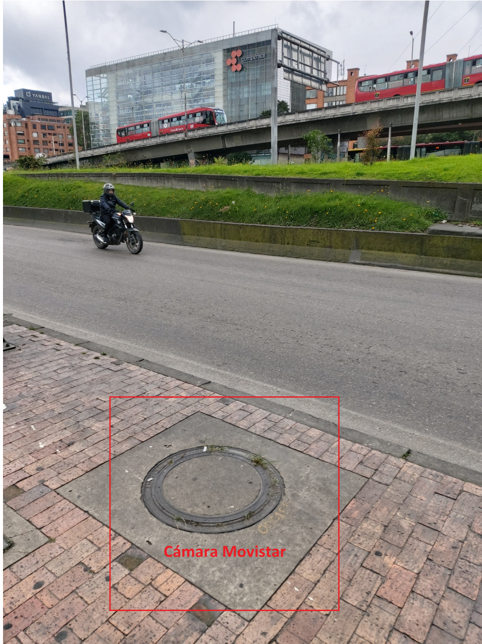
Fotografía 11. Redes de MOVISTAR sobre la Autopista norte salida carrera 30 al sur Fuente: Imagen en campo
