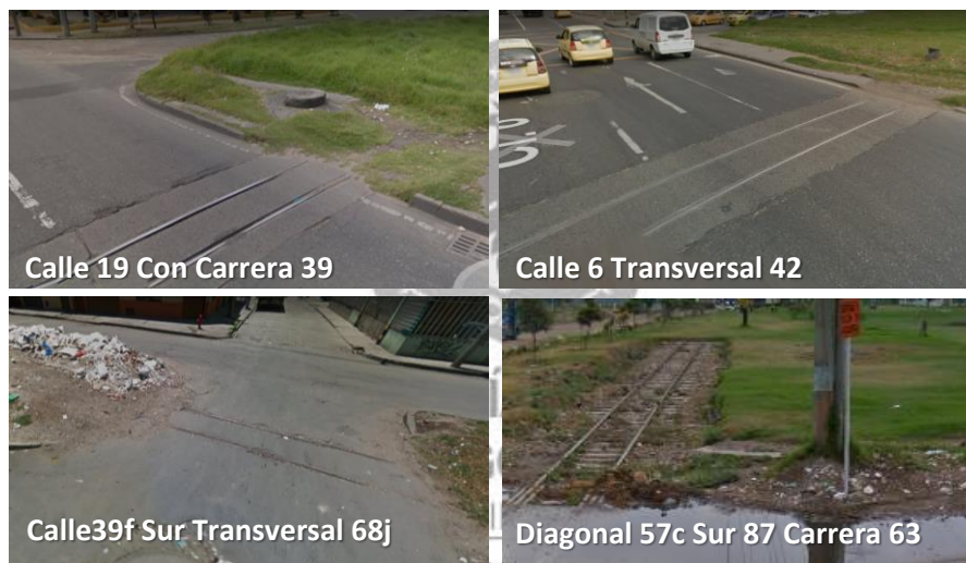
Figura 5. Condición de los rieles del antiguo corredor férreo del sur.
